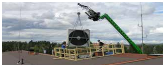
Smedsberget 20 (äldreboende) - ombyggnad ventilation
